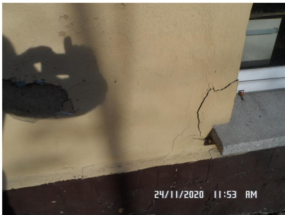
5. Widoczne pęknięcia muru przy oknie
