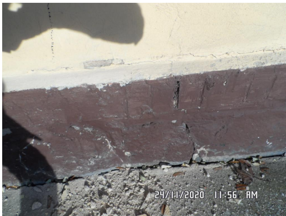
7. Pęknięcia murów fundamentowych
