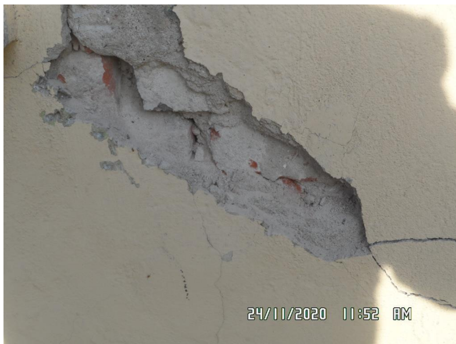
3. Widoczne pionowe pęknięcia muru
