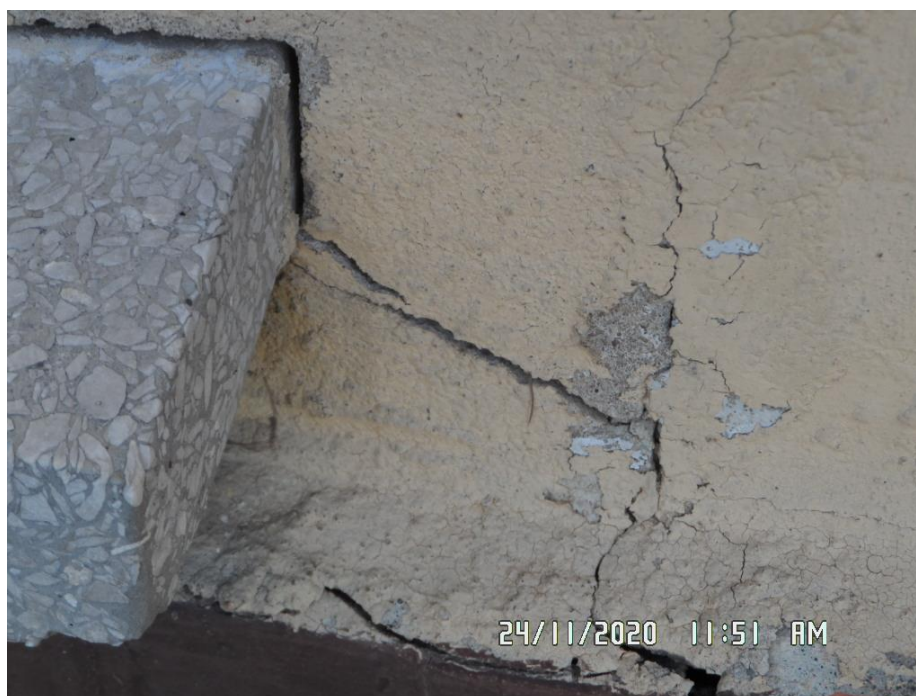
2. Widoczne pionowe pęknięcia muru
