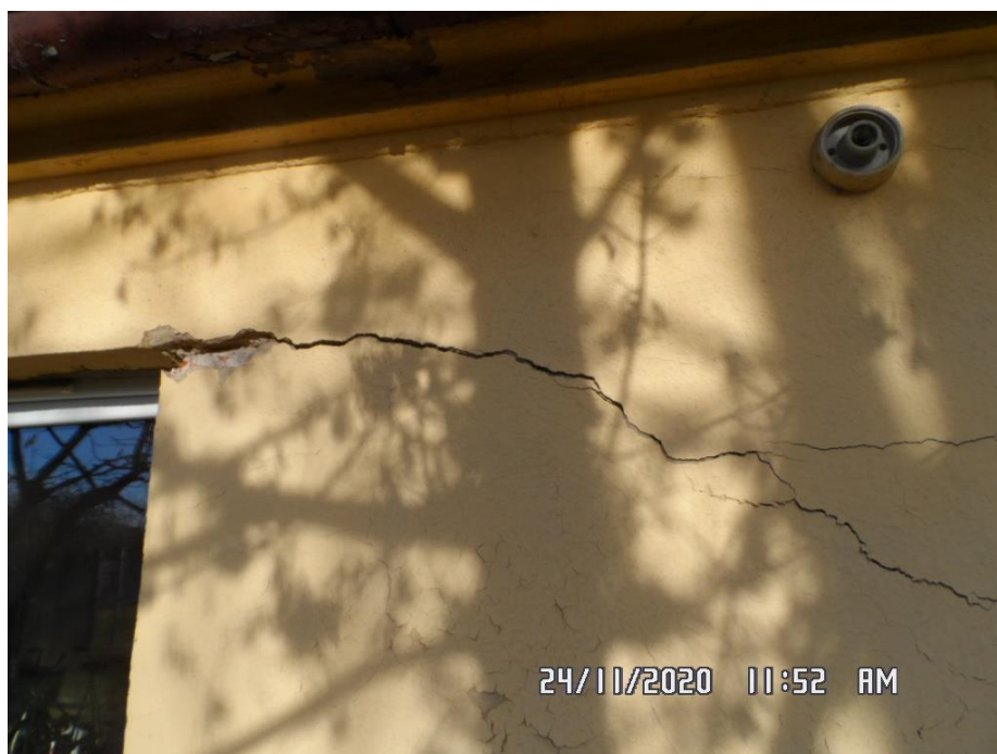
4. Widoczne poziome pęknięcia muru
