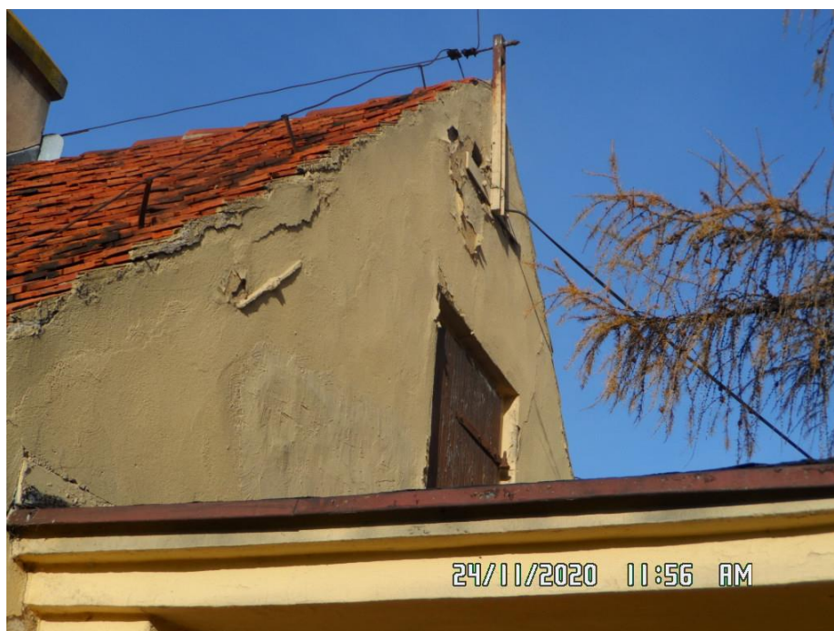
8. Zły stan tynków na przeciwnej ścianie szczytowej
