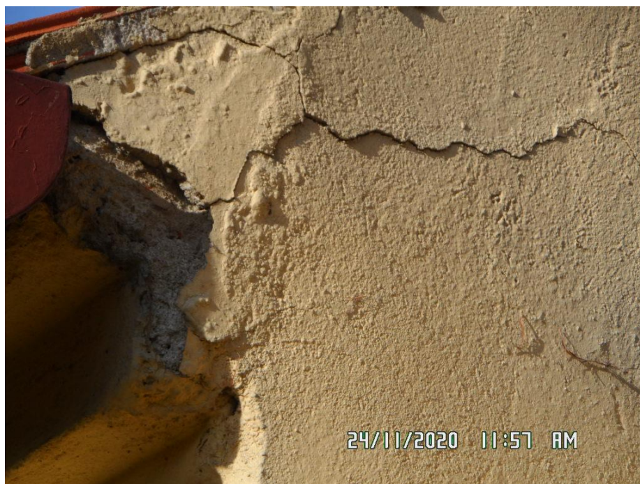
9. Pęknięcia przy okapie
